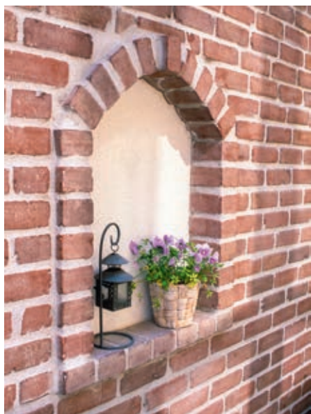
Die dahinterliegende Betonwand wurde verblendet, ausgespart ist eine Mauernische zum Abstellen von Kleinigkeiten und als optischer Aufputz.
